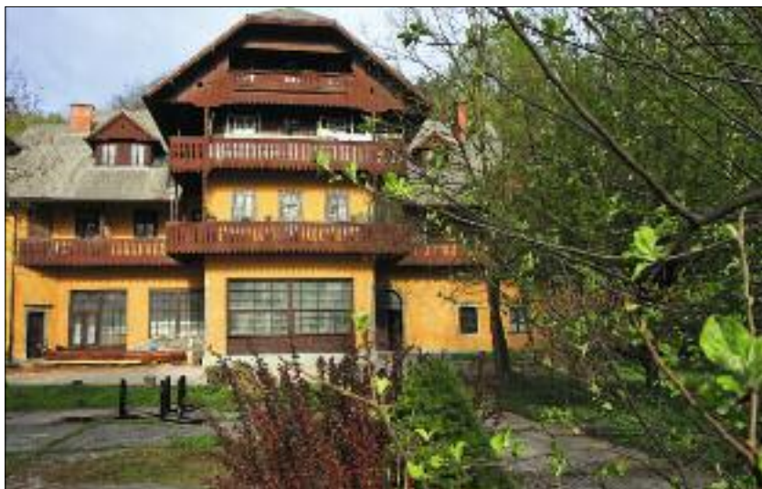
Slika 41: Za zdaj nekdanj privlačen objekt nezadržno propada.
