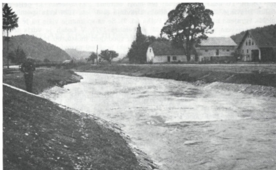
Sl. 2. Močno spodjedena regulirana struga Dravinje v Draži vasi. Do poškodb je prišlo ob poplavi 5. 10. 1974
