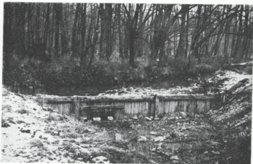
Sl. 56. Talni prag (pregrada) na začetku razbremenilnika Moste - Stržen
