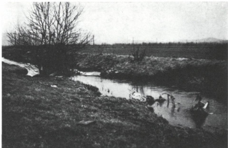
Sl. 77. Če najmanjša ovira na dnu korita lahko preusmeri udarno moč vodnega toka. Voda je pričela razjedati ne dovolj utrjeni in nezavarovani desni breg Pšate (pod Trzinom)
