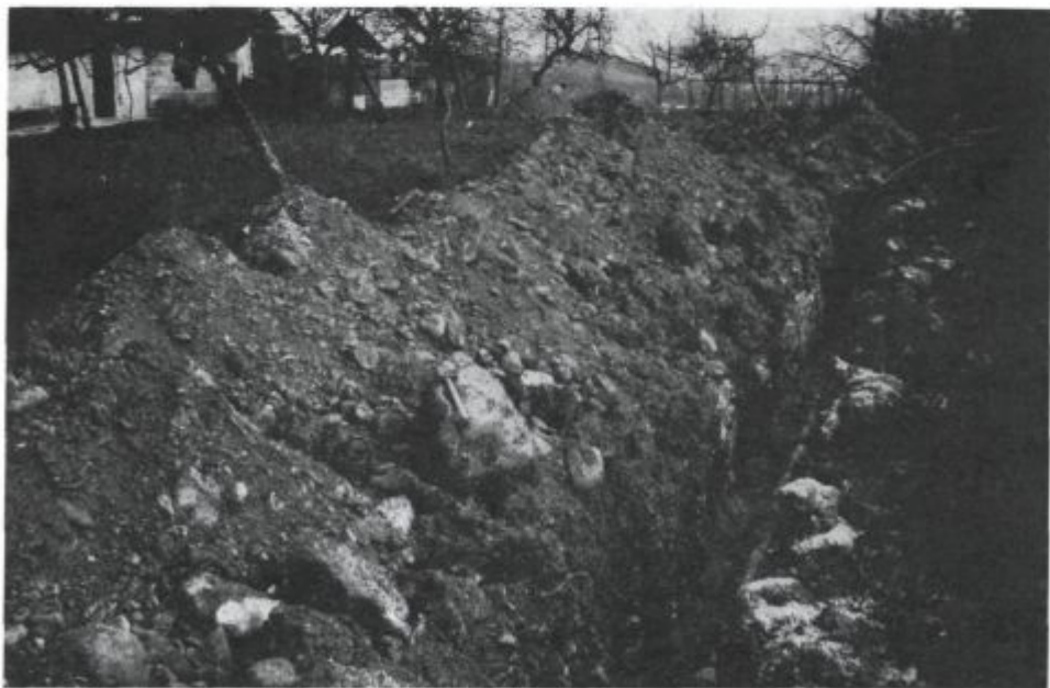
Sl. 31. Tako debel prod so razkrili jarki za vodovod v Dobravi pri Konjicah (terasa 2). Za primerjavo nam služi kladivo na enem od večjih prodnikov
