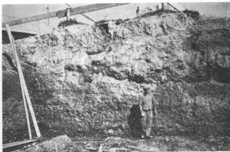
Sl. 23. Globok izkop za novo šolo v Hočah je na široko razkril peščene ilovice in prod, ki ga je nanosila Reka s Pohorja
