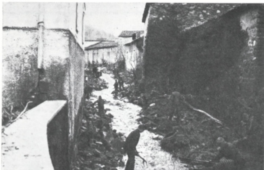
Sl. 26. Obzidana struga Mrzlega potoka pod izlivom Kočevskega potoka. Domačini čistijo in poglabljajo korito, da bi voda nemoteno odtekala. Na desni izrjavano drevo. Struga je na tem mestu zasuta 1,5 do 2 m na visoko
