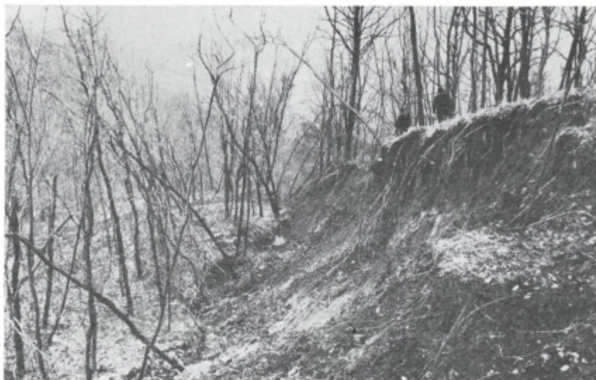
Sl. 10. Desni rob usada v vzdolžni smeri. V reliefu so lepo vidni trije elementi: višina prvotnega pobočja na desni, podolžni odlom v sredini ter znižano, položno površje usada na levi. Svetla lisa sredi odloma so plasti flišnega laporja. Usajeno površje je skoraj nedotaknjeno, le tu in tam so razpoke in nagnjena drevesa
