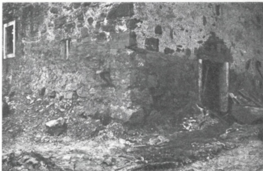
Sl. 29. Črta na zidu kaže, da je bila hiša zatrpšana z blatom do podbojev vrat
