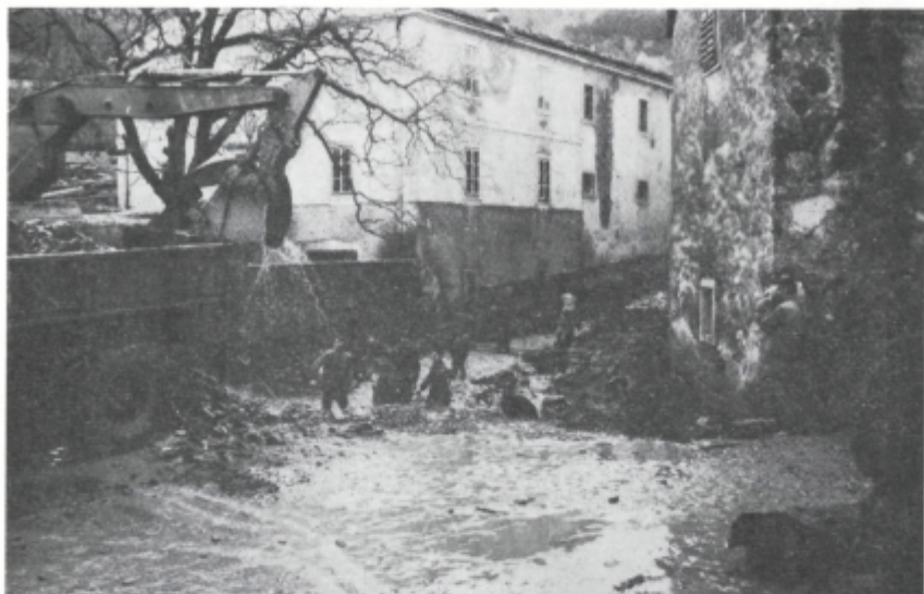
Sl. 28. Odvažanje nakopičenega materiala iz že napol očiščene struge pri mostu sredi vasi. Temna proga na hiši priča, da je ob glavnem navalu vdiralala voda v kleti
