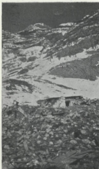
Sl. 13. Porušena domačija vulgo Jezl na Ravnah pri Bovecu
