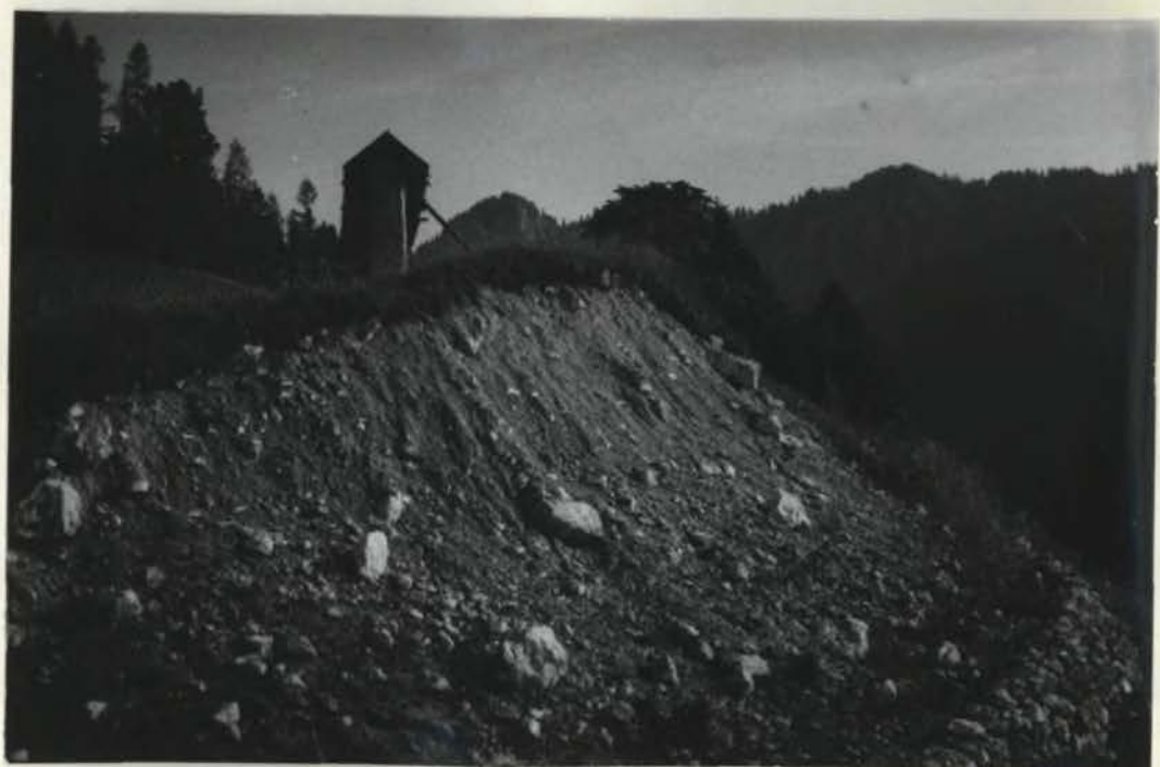
2 Sl.6 Cesta, ki pelje iz Sorice proti Podhrdu se globoko zareže v morenski nasip na desni strani Sore. Značaj gradiva v njej vidimo na priloženi sliki.
