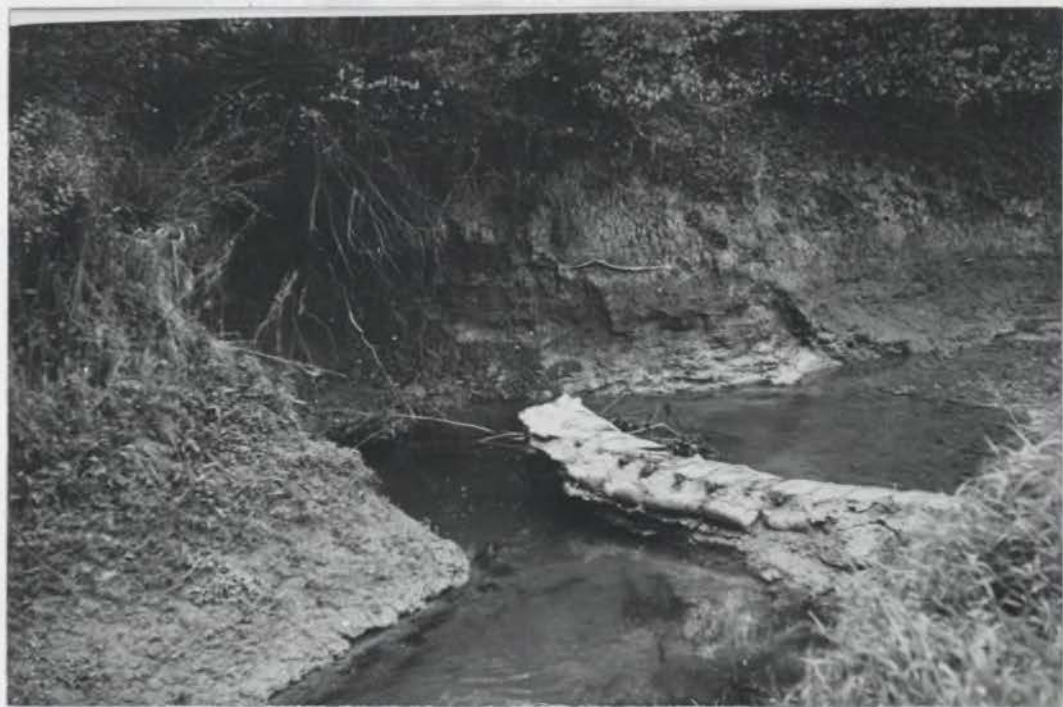
Sl. 10. Prečna pregrada /zabetonirane vreče, napolnjene s peskom/ v dnu korita Dobravke v severozahodnem delu Radenskega polja, ki naj bi zaustavila začenjsko erozijo potoka, je v mehkih drobnoklastičnih peščeno-illovnatih sedimentih pospešila na levem bregu bočno erozijo; ob pregradi potok nemoteno globinsko erodira.
