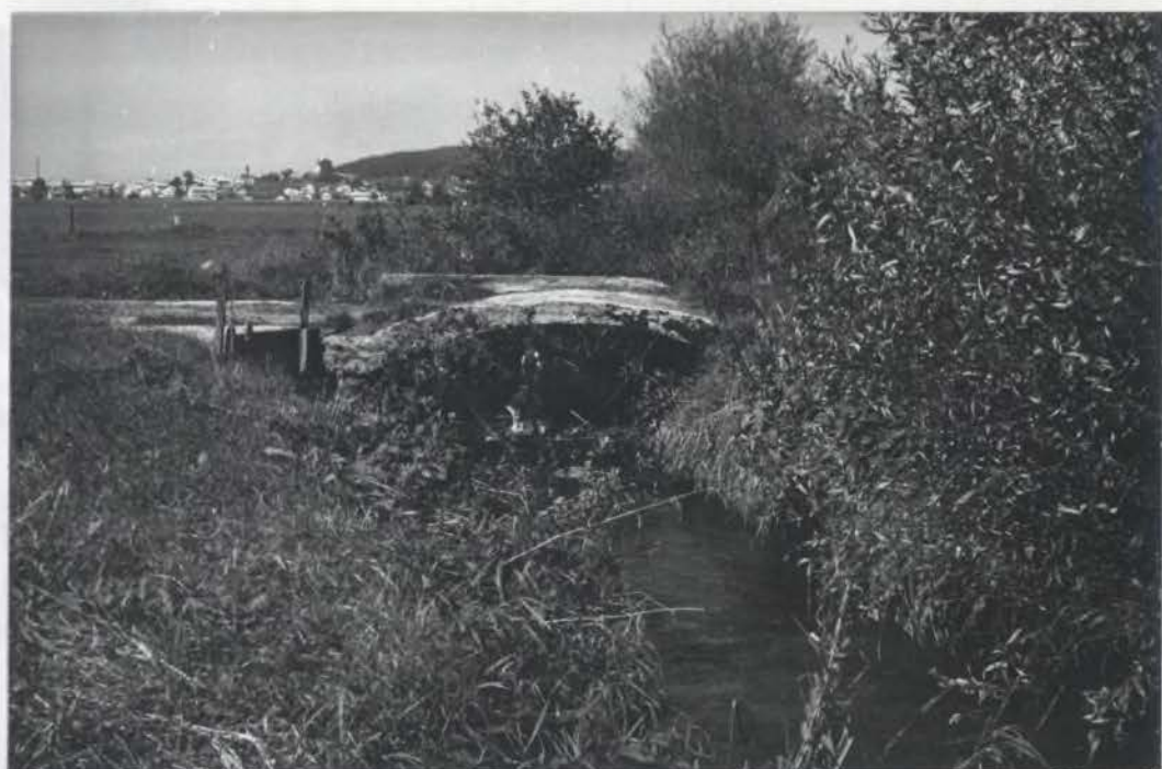
Sl. 5. Ločni most čez neregulirano Dobravko tik nad sotočjem z Gatinskim potokom.
