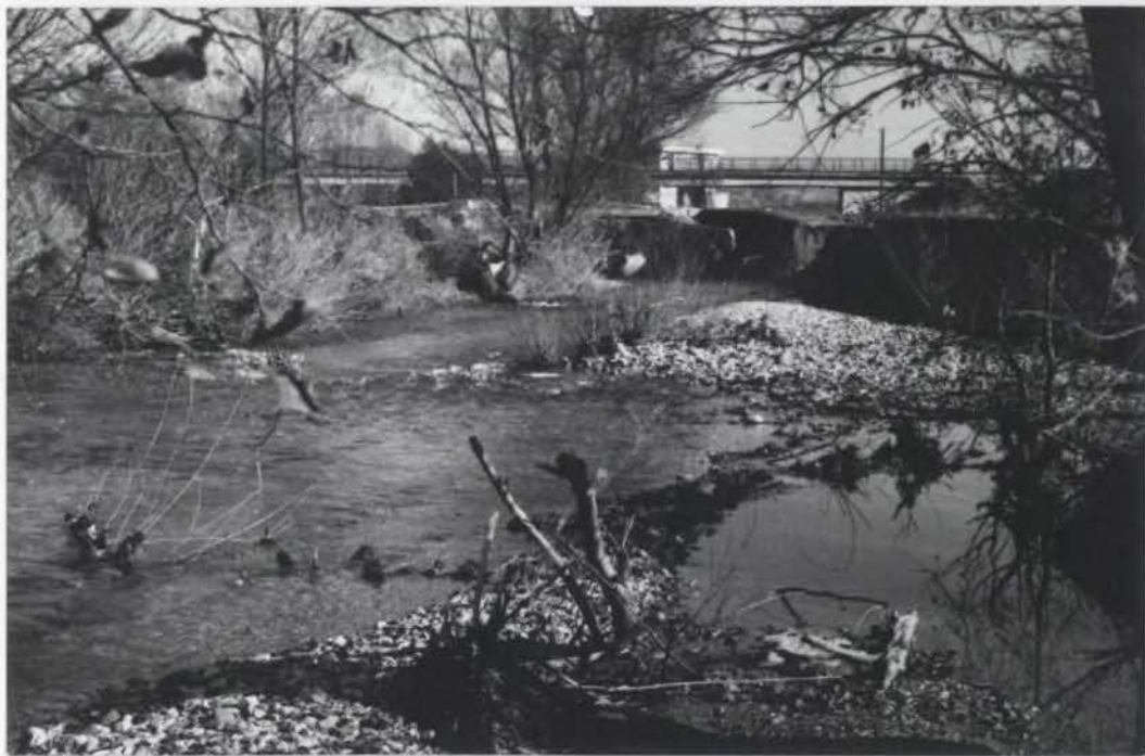
Sl. 10. Pred izlivom p. Bistrice v Sotlo. Aktivna bočna erozija izpodjedla betonski most in ga močno poškodovala. V strugi zasledimo večje deponije proda in peska.
