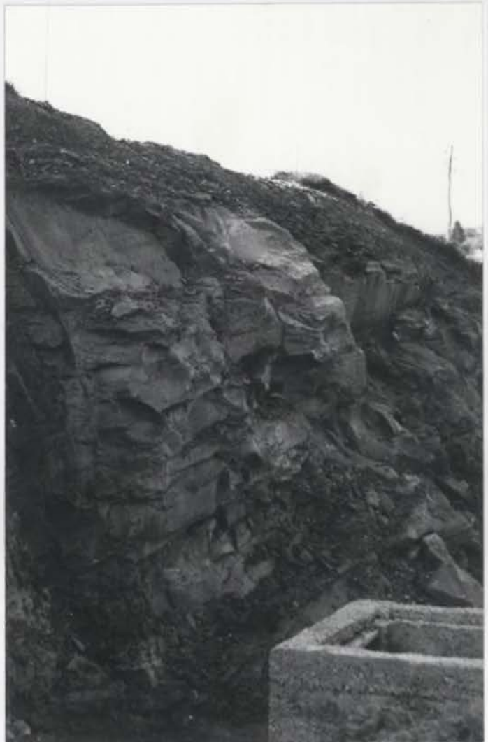
Sl. 26. Usek v lapornate škrljavce pri Bistrici ob izgradnji nove asfaltne ceste.
