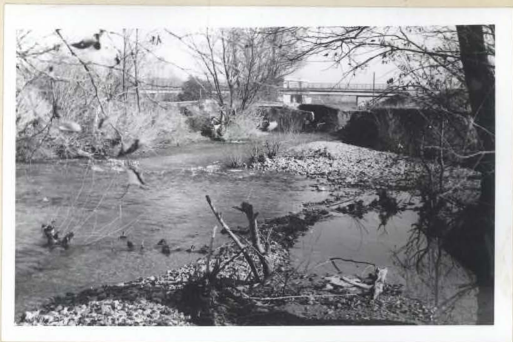
Sl.10 Pred izlivom p. Bistrice v Sotlo. Aktivna bočna erozija izpodjedla betonski most in ga močno poškodovala. V strugi zasledimo večje deponije proda in peska.
