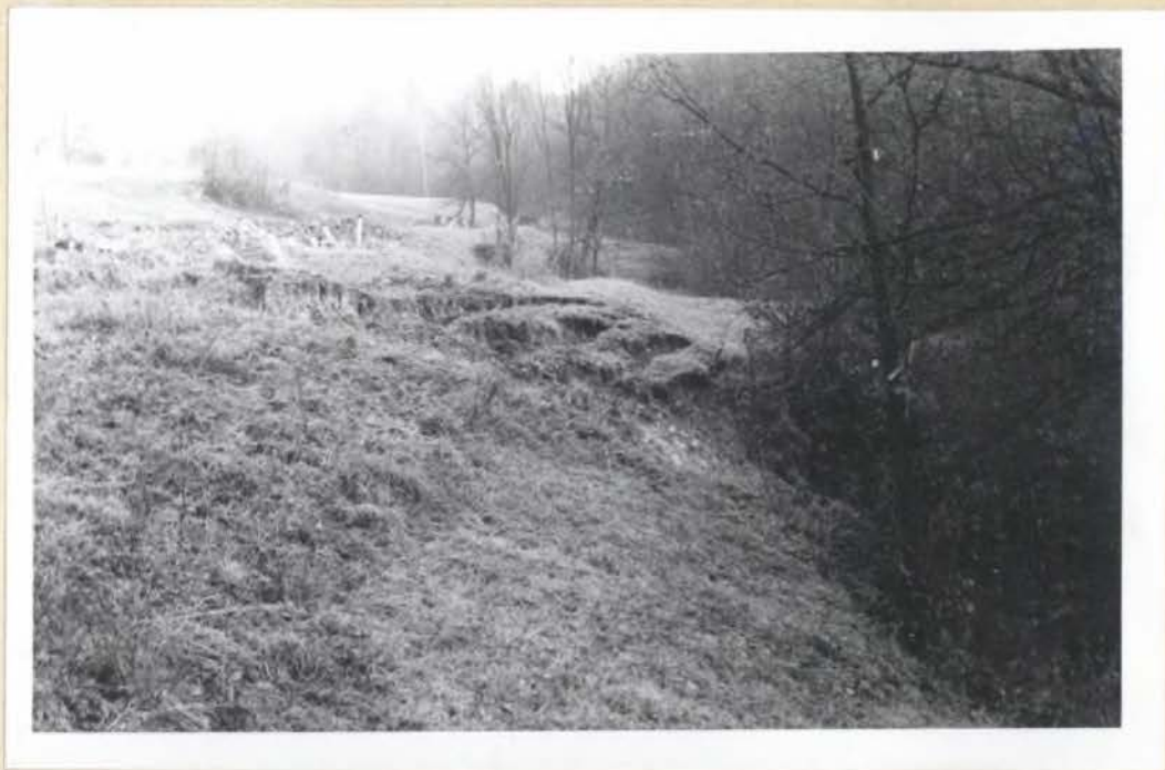
Sl.19 Izpodjedanje i n bočno trganje brežin p. Sušice je bilo vzrok usadu, ki je poškodoval cesto Pilštanj-Golobinjek cca 2.5 km nad Pilštanjem in zgrmel direktno v strugo potoka.
