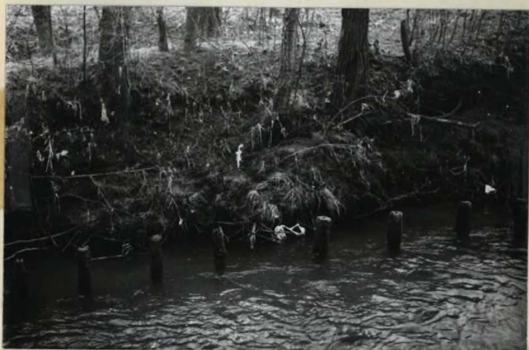
Sl. 20 Nadaljnje izpodkopavanje brega Pšate je človek zavaroval z lesenimi piloti. (Pod Malenškoviim jezem pri Komendi).
