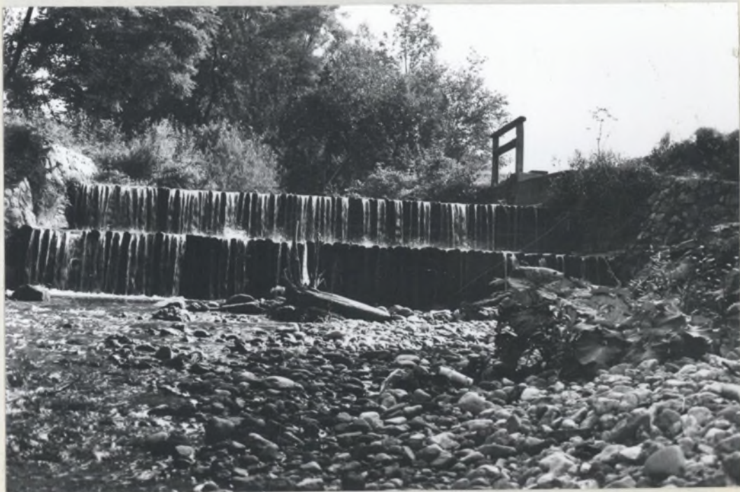
Sl.12 Pogled na Soržev jez (Polže pri Strmcu), ki stoji na Hudinji. Leta 1925 so zgradili betonski jez, ki ga je odnesla septembrska povodenj 1964. leta. Potem so postavili skupaj z vodno skupnostjo iz Celja leseni jez. Voda je poganjala Soržev mlin do 1953. leta, žago do 1974. leta, ko odjavi obrt, turbino za dinamo, sadni mlin, cirkularsko in kovačnico.
