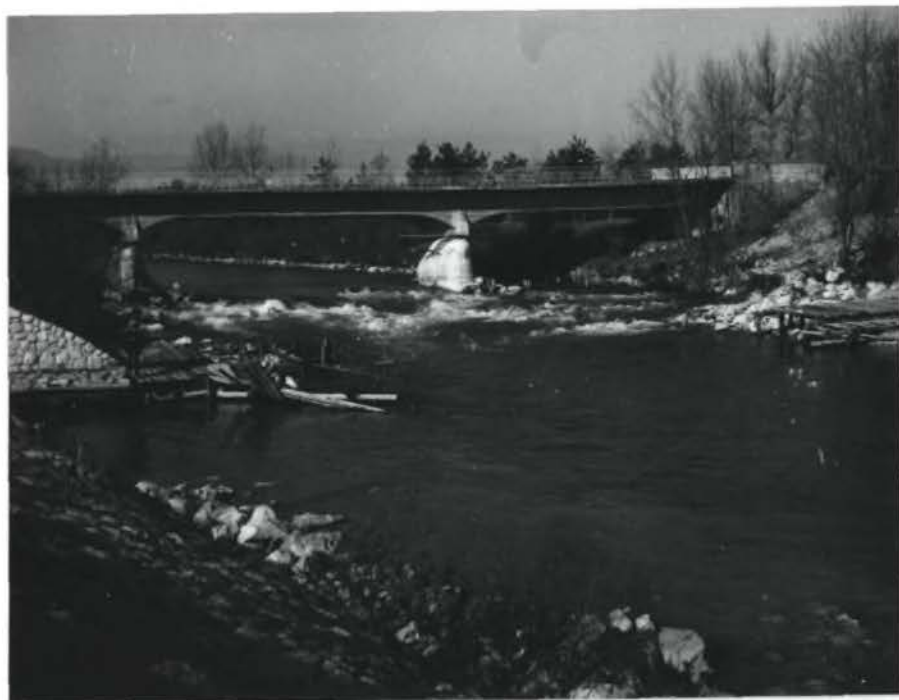
Sl. 7. Ob naraslih vodah je Savinja še vedno nevarna reka. Med Polzelo in ustjem Bolske, kjer znaša njen strmec 3,7‰, je zanjo značilna globinska erozija. Ob jesenski povodnji 1973. leta je izpodkopala temelje nosilcem grobeljskega mosta.
