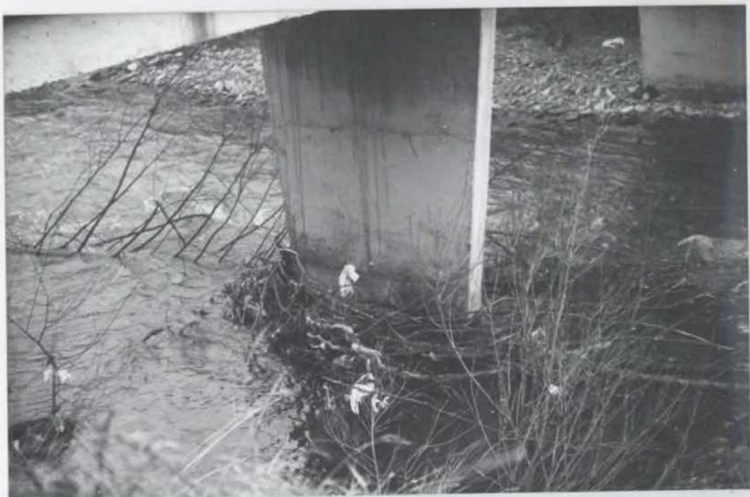
Sl. 10. Ob mostovih preko Rižane se predvsem ob visoki vodi nabira dračje ter zastaja material, zlasti na odsekih kjer poteka železnica stran od struge in leta ni poplavljen in reguliran.
