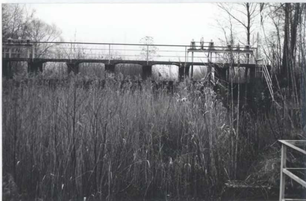
Sl. 9. Razbremenilnik Rižane ne opravlja svoje funkcije in ga zarašča trstika.
