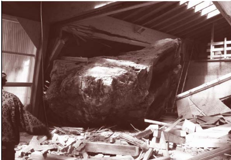
Conseguenze di una caduta massi in Längenfeld, Tirolo (Austria)
